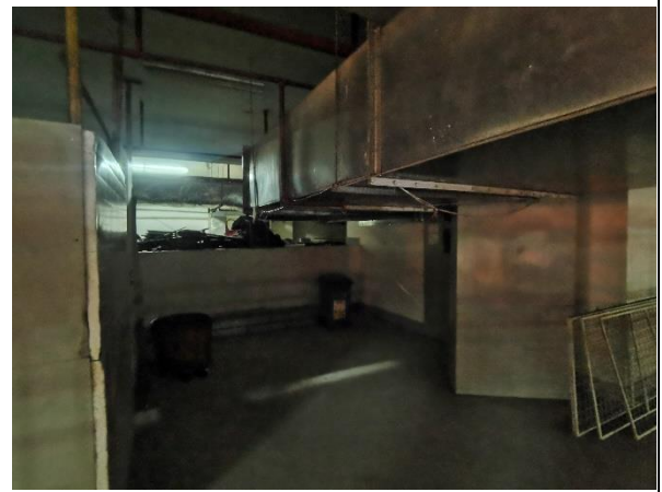
上方进风机房和走道
