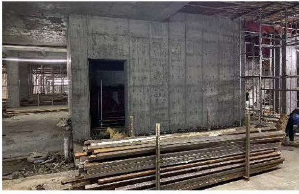
地下负二层拟建后装机房位置
