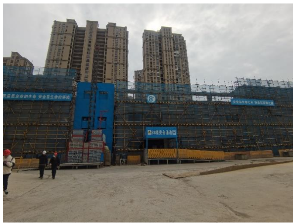
项目南侧动力设备中心（二期）
