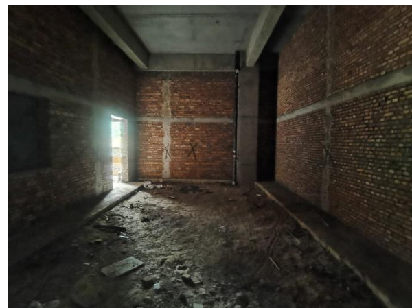
医技及门急诊楼（二期）1楼 SPECT/CT 机房
