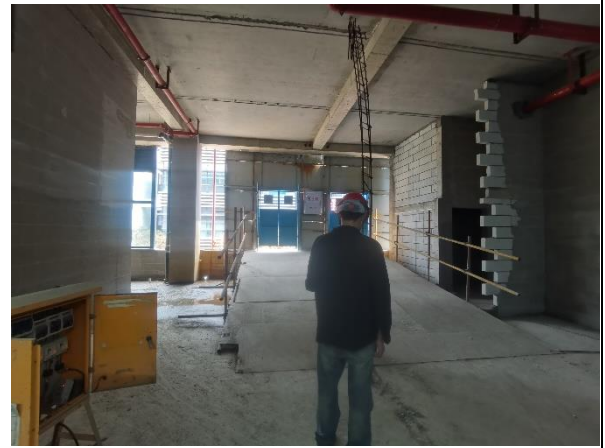
医技及门急诊楼（二期）2楼机房和办公通道 （手术室 OR16 下方）
