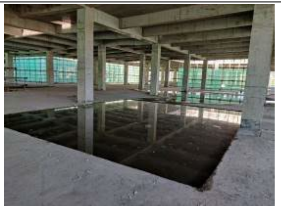
DSA 机房拟建址
