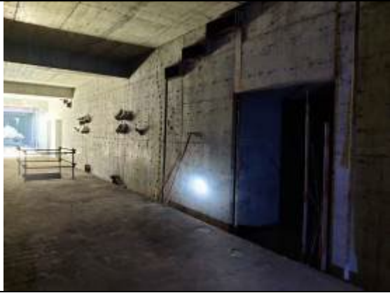
直线加速器机房
