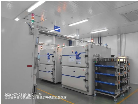
6#CT 检测区南侧 Baking 区
