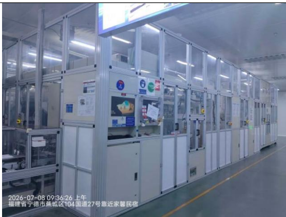
6#CT 检测区北侧干燥房设备
