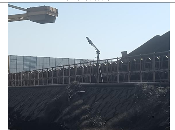
煤场喷淋设施
