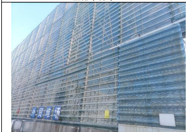
煤场防尘网设施
