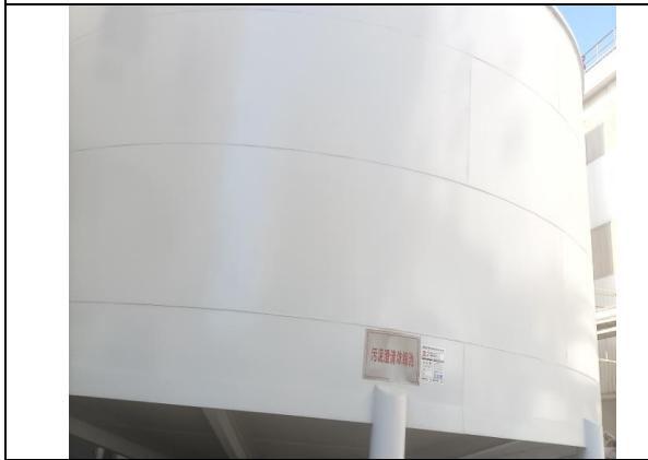
脱硫废水处理系统
