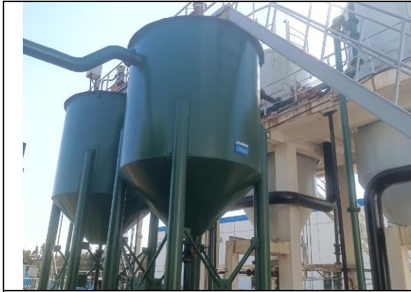
含煤废水处理系统
