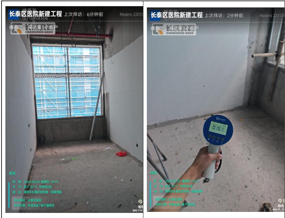
DSA 手术室楼下值班室
