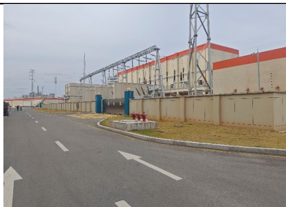
S13 厂房北侧：S15 变电站、厂内道路
