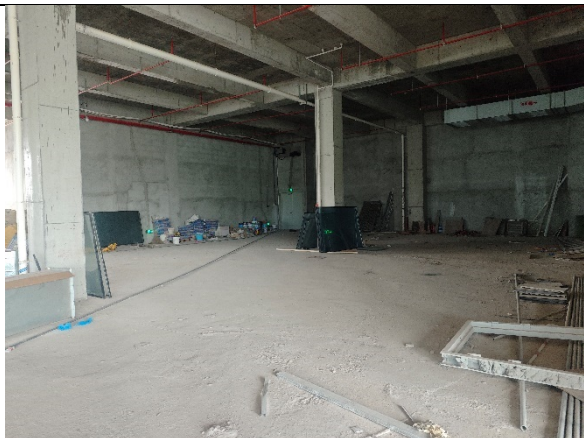
CT 测试室东侧：发电机房
