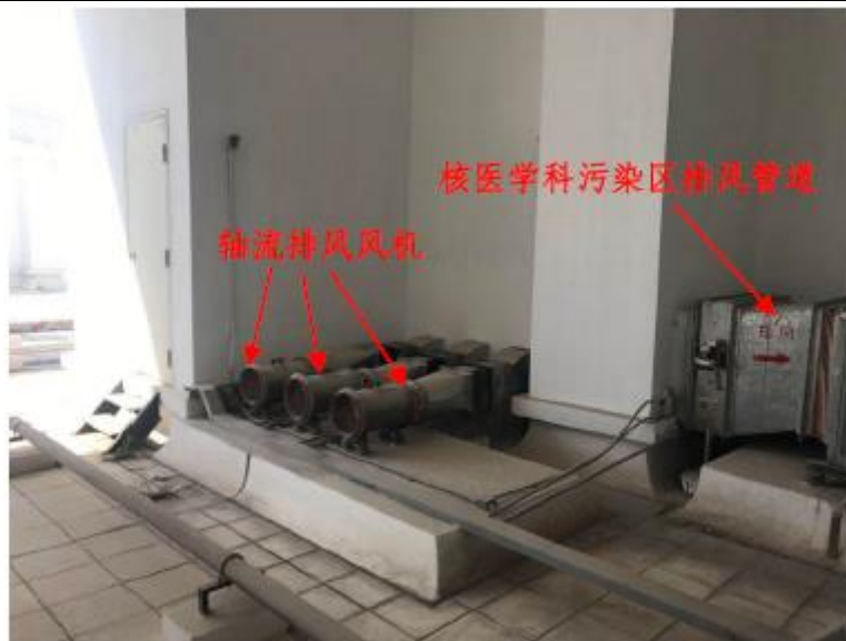
图11-3 门诊综合大楼主楼17楼楼顶的核医学科污染区专用排风口
