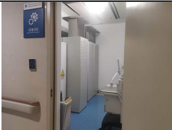
DSA2 机房东北侧设备间
