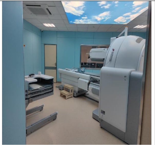
核医学科 SPECT/CT 机房
