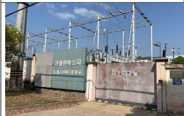
西侧：沙县供电公司 110kV 变电站
