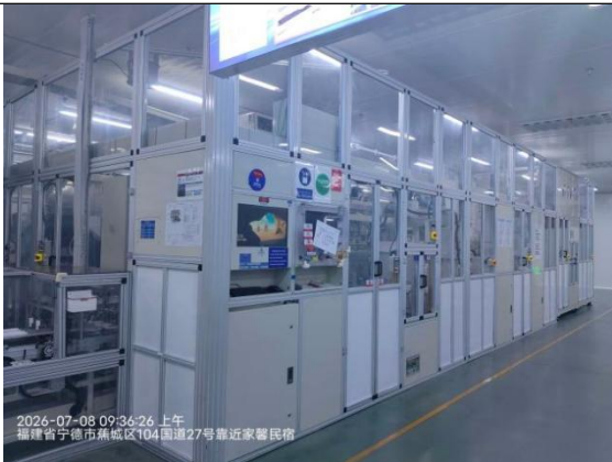
6#CT 检测区北侧干燥房设备
