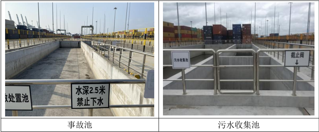
图 3.6-5 A9-A10 危货堆场事故废水处理设施
